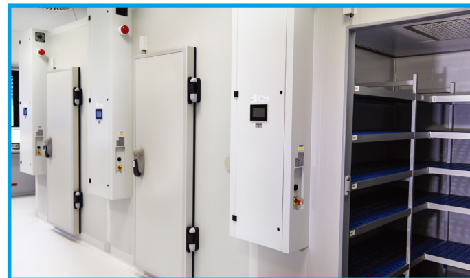
步入式稳定性试验箱总承包项目
